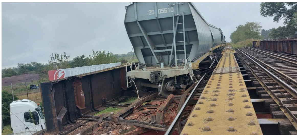
Figura 4. Tramo central del puente afectado por el suceso. Fuente: JST, 2022
