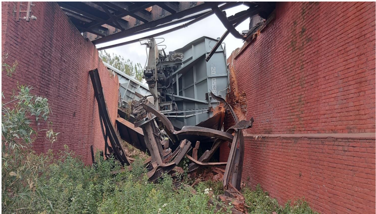
Figura 1. Derrumbe de la sección sur del puente La Virginia y caída de los vagones del tren H66 sobre el enlace de vía que une al Cabín 13 y la estación Pérez. Fuente: JST, 2022
