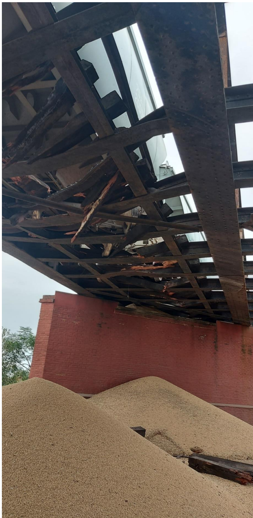
Figura 7. Daños en la sección central del puente y pérdida de carga de los vagones afectados. Fuente: JST, 2022
