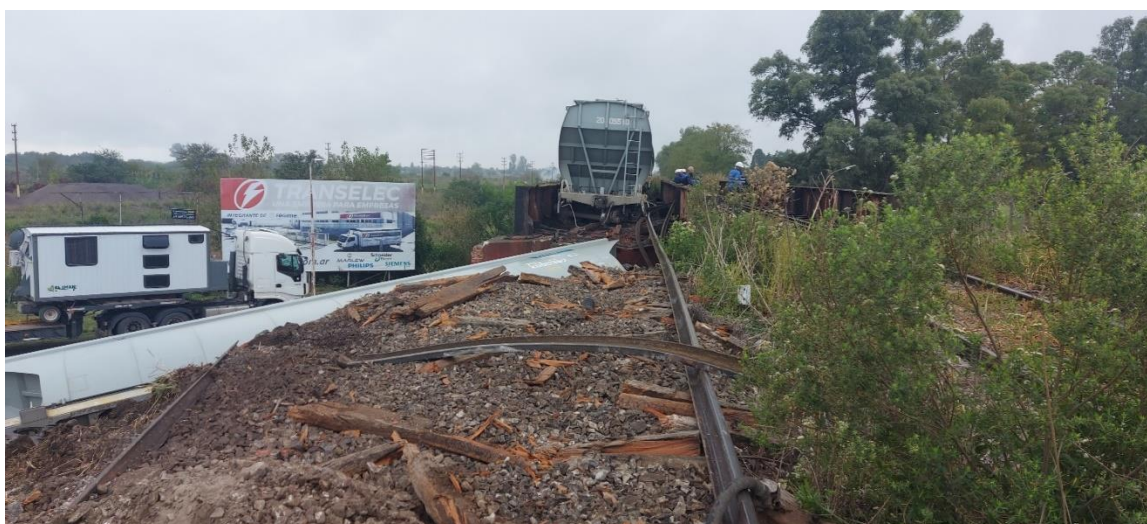
Figura 5. Vista general de la infraestructura de vía dañada. Fuente: JST, 2022
