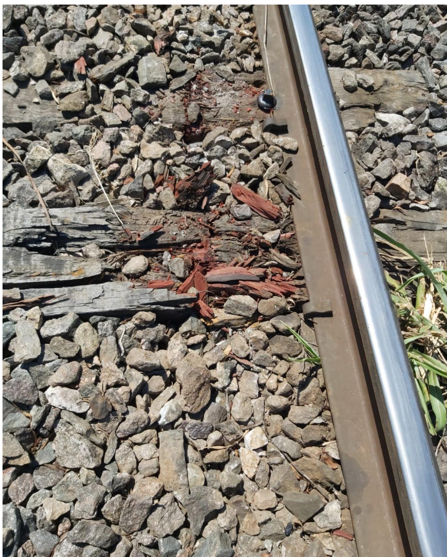
Figura 1. Daños en la superestructura de vía. Fuente: JST, 2022
