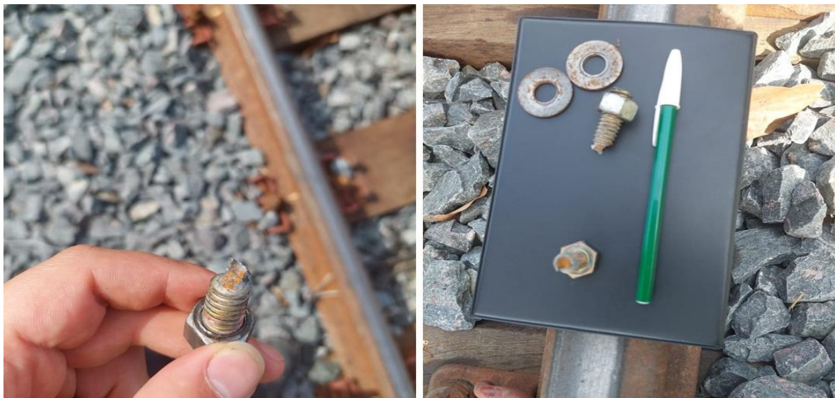
Figura 10. Tornillos encontrados sobre la vía durante el relevamiento. Fuente: JST, 2022
