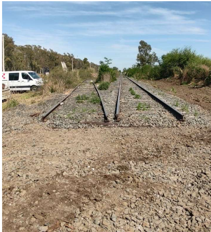
Figura 2. Zona del aparato de vía afectado por el descarrilamiento. Fuente: JST, 2022
