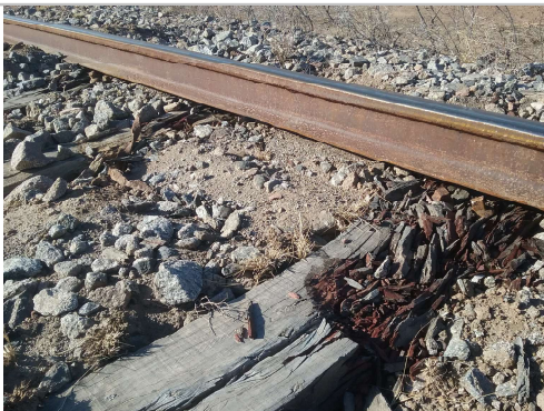
Fig. 3. Estado general de la superestructura de vía metros antes del lugar del suceso
