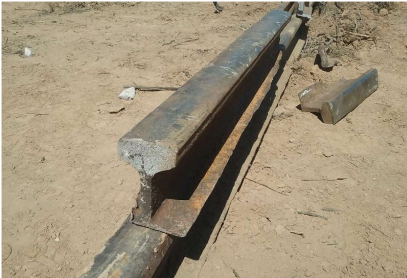
Figura 4. Riel fracturado en el lugar del suceso. Fuente: JST, 2022
