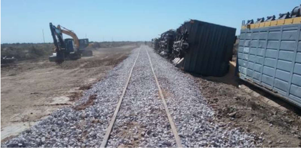
Figura 6. Vagones tolva con desprendimiento de sus boguies. Fuente: JST, 2022
