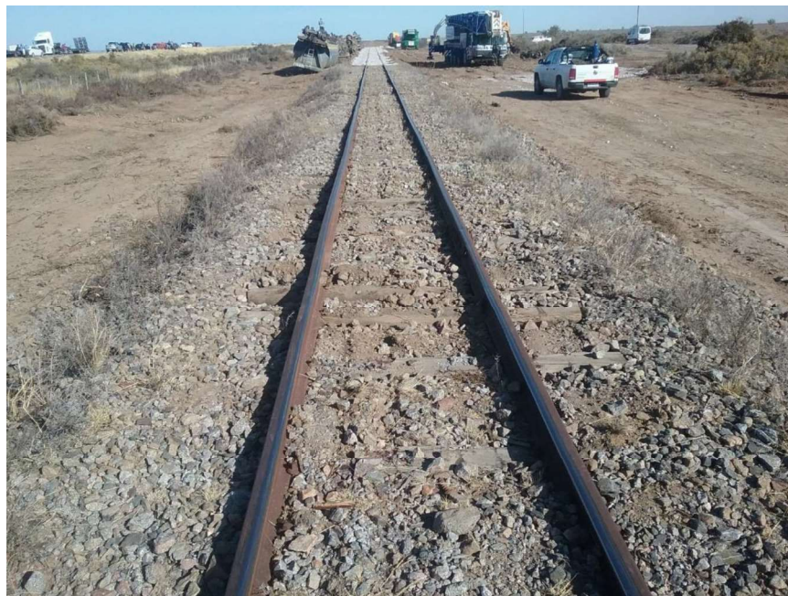
Figura 2. Vista general del tramo de superestructura de vía donde ocurrió el suceso. Fuente: JST, 2022
