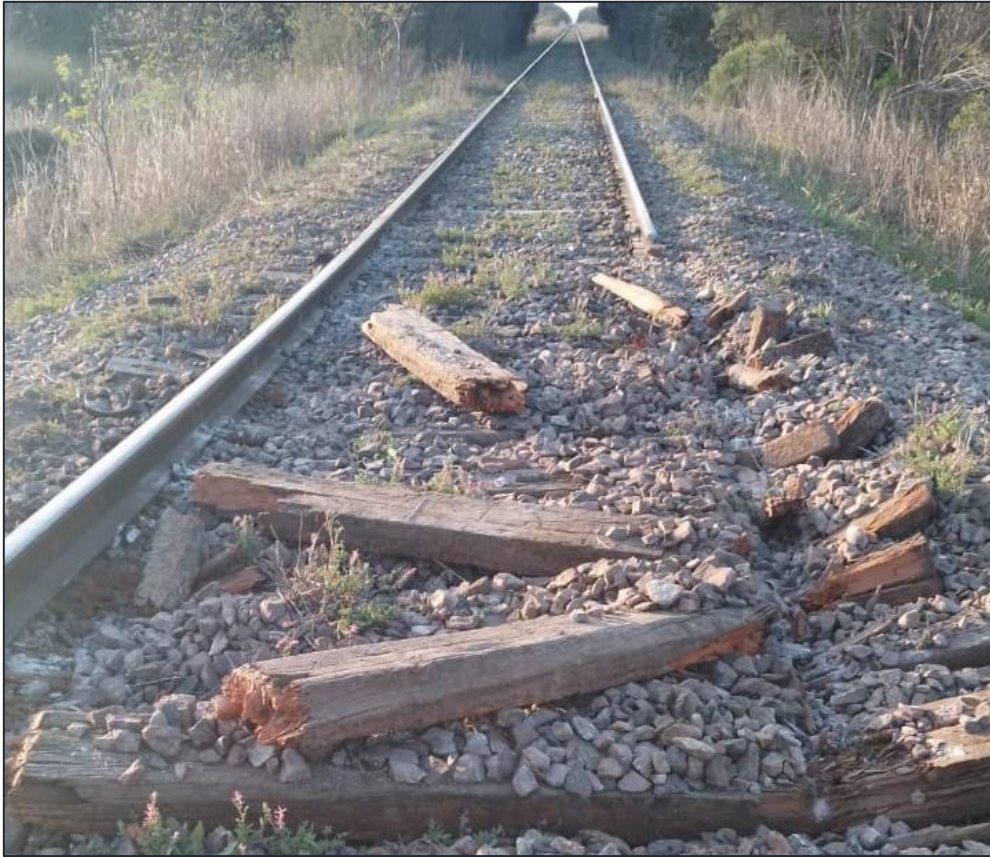
Figura 2. Durmientes de madera quebrados. Fuente: JST 2023
