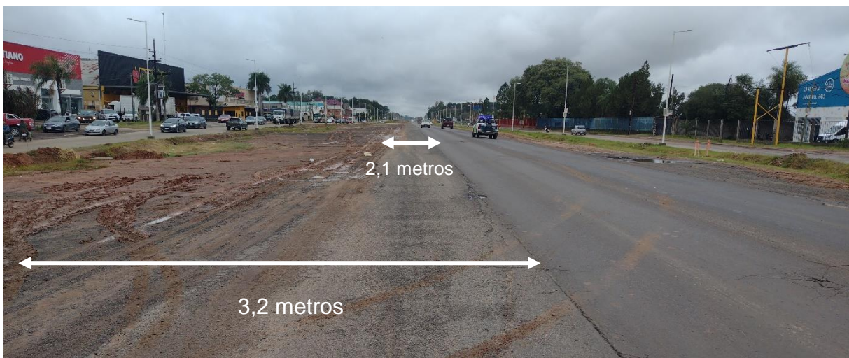
Figura 6. En la imagen se puede apreciar el estrechamiento de la banquina contigua al carril ascendente. Fuente: JST, 2023
