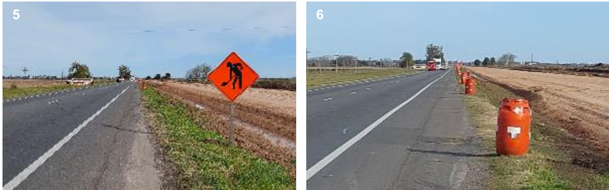
Figura 5. Señalización vertical y barriles transitorios para el sentido de circulación del Vehículo 1.
