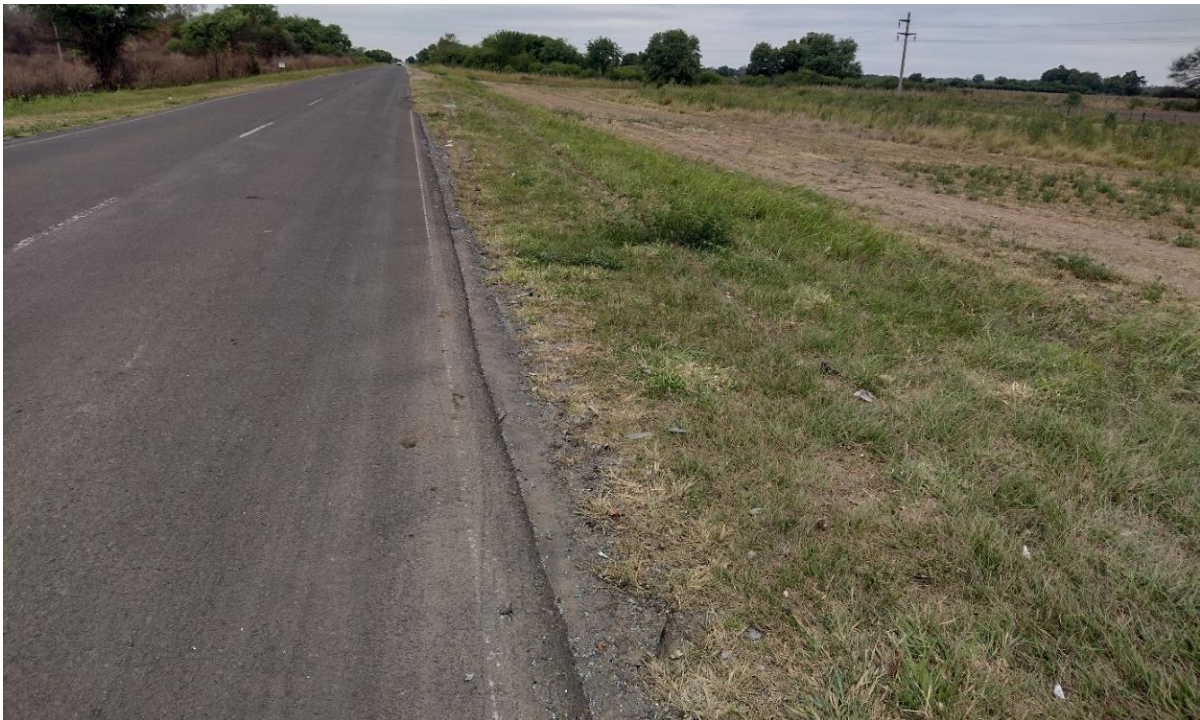
Figura 15. La imagen muestra las marcas de neumático posimpacto producidas por el Vehículo 1 sobre la banquina contigua al carril descendente de la ruta. Fuente: JST, 2023
