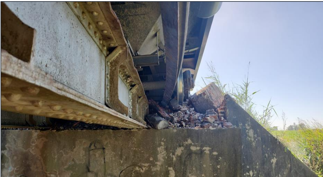
Figura 8. Alcantarilla afectada por el impacto de uno de los vagones descarrilados. Fuente: JST 2024
