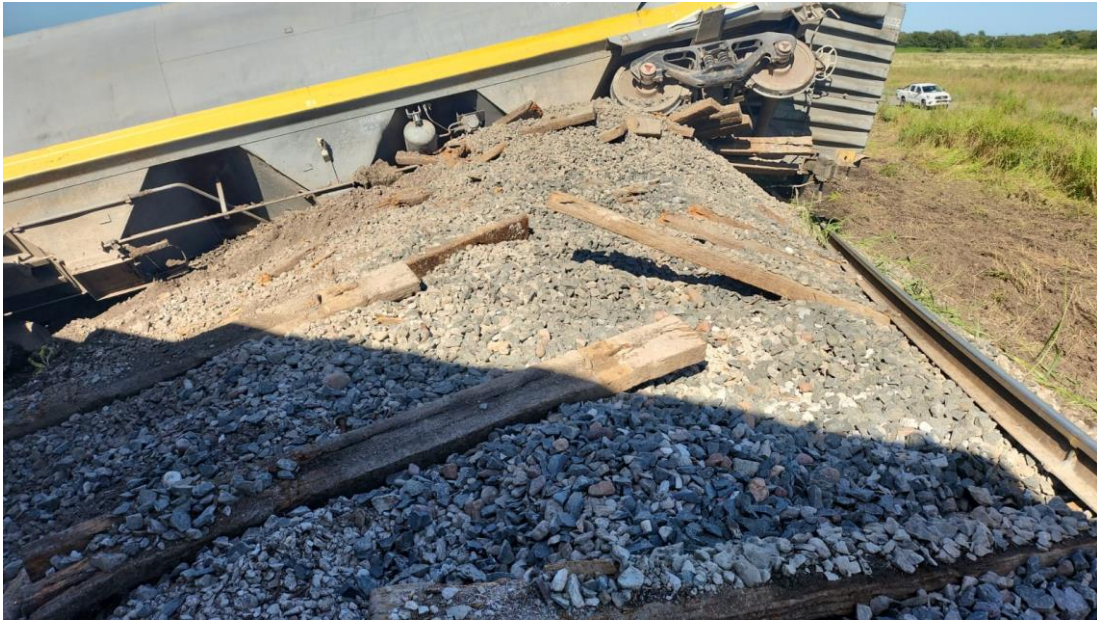
Figura 8. Daños en la infraestructura de vía. Fuente: JST, 2024
