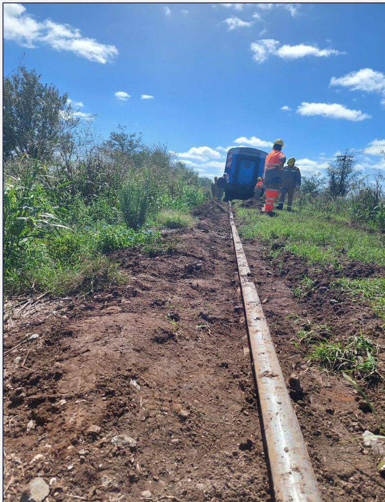
Figura 4. Vista desde aguas abajo del estado de la infraestructura tras el suceso.
