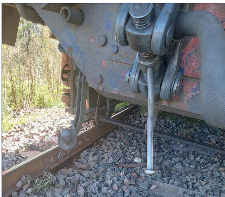
Figura 4. Vista de la última rueda del lado izquierdo en el sentido de marcha. En la imagen se aprecia la torsión del riel. Fuente: JST, 2024
