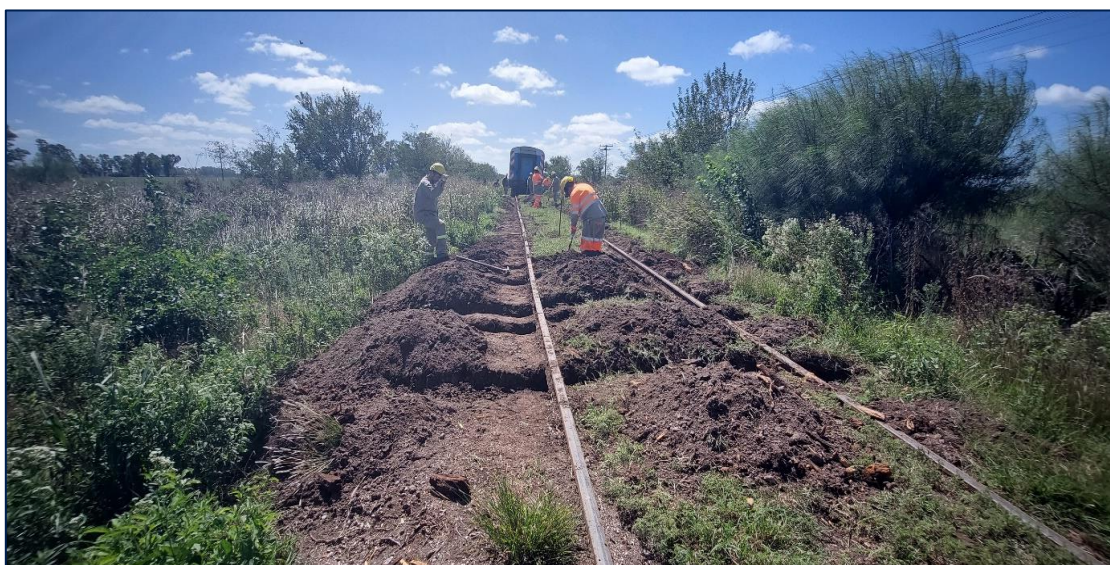
Figura 5. Vista general de los daños y de las tareas de reparación aguas abajo del descarrilamiento. Fuente: JST, 2024
