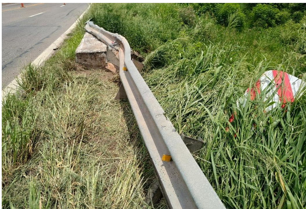
Figura 5. Daños constatados en el extremo sur de la contención lateral y del muro de la cabecera oeste de la alcantarilla. Fuente: JST, 2024
