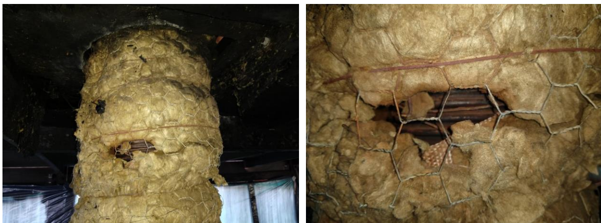
Figura 12. Detalle de una zona con faltante de aislación térmica del sistema de exhaustación cerca del cielo de la lancha. No se aprecian zonas quemadas por el incendio, esto indica que esta condición era preexistente al suceso.
