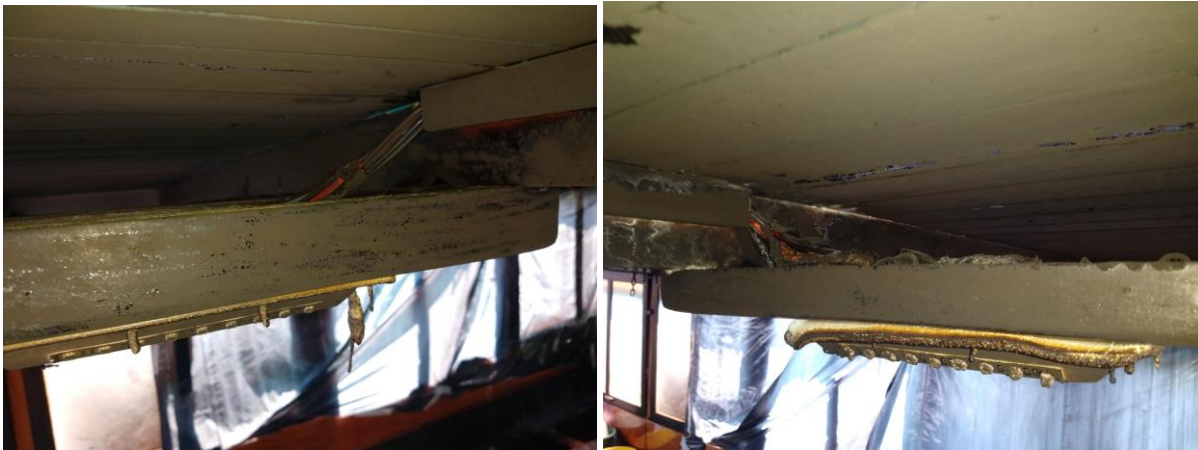
Figura 14. Daños en luminarias y cableado, sector medio de la lancha. Fuente: Material documental
