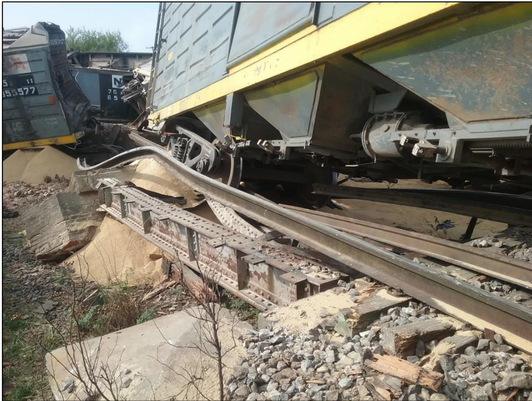
Figura 7. Daños graves en la superestructura de vía aledaña a la alcantarilla. Fuente: JST, 2024
