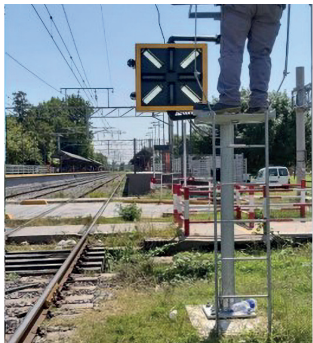
Figura 4. Instalación del Semáforo al Tren en el ramal Plaza Constitución-La Plata de la línea Roca
