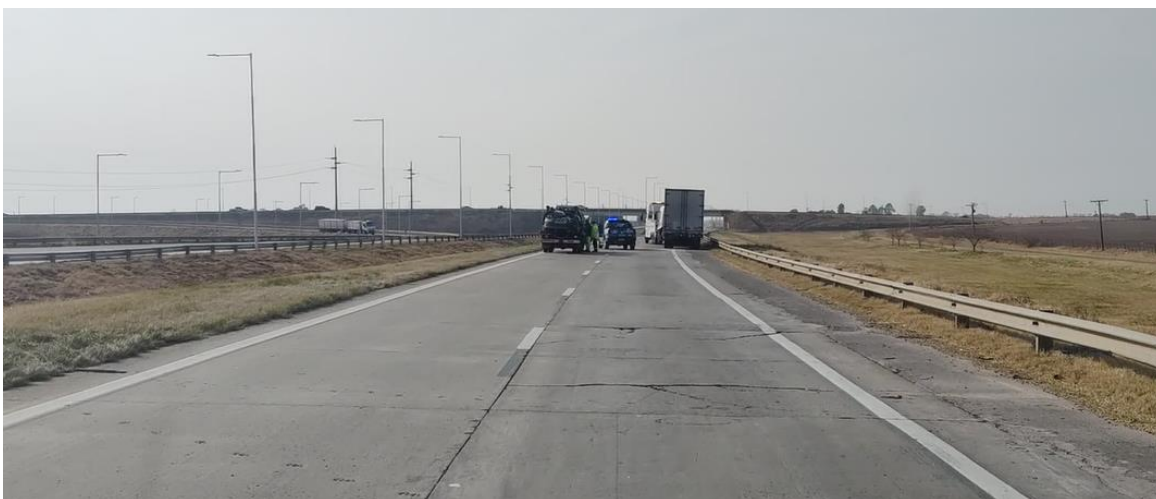
Figura 5. Vista hacia Correa. Señalización horizontal en el lugar del suceso y barreras de contención semirrígidas. También, desintegración de bordes. Fuente: JST, 2024
