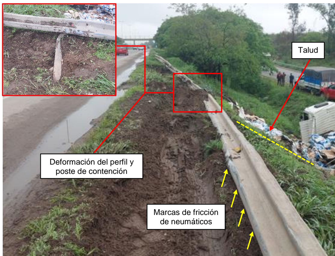
Figura 7. Demarcación de los daños a la infraestructura vial. Fuente: JST, 2023
