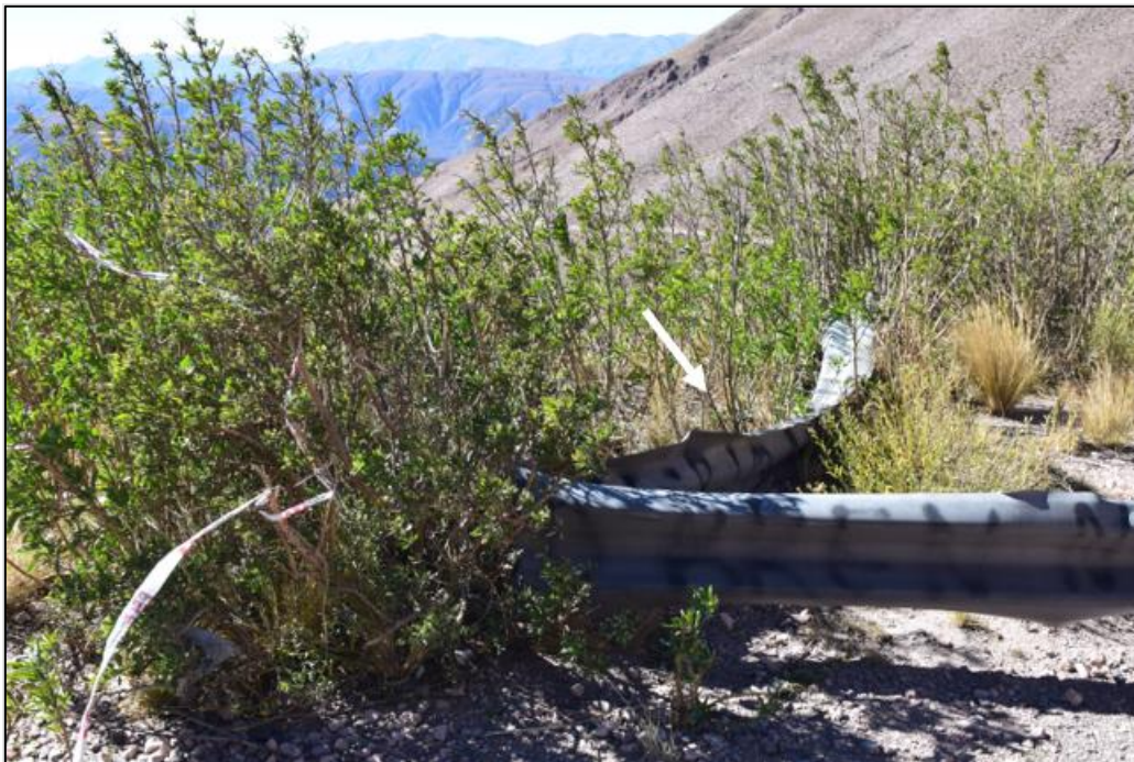
Figura 4. Extremo de la barrera deformado por el impacto
