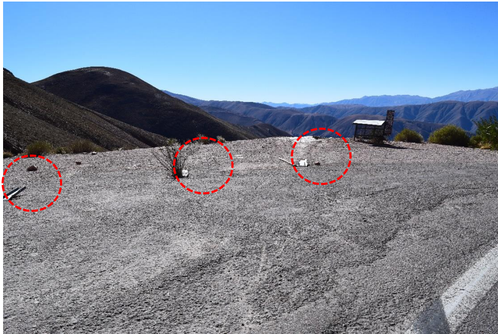
Figura 19. Postes de la barrera arrancada dañados por el vehículo volcado
