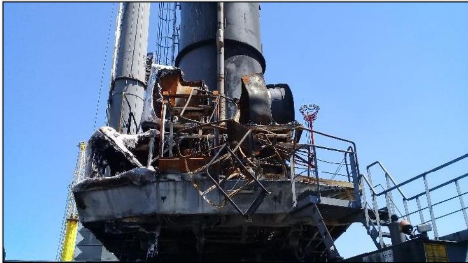
Figura 31. Daños sobre la parte frontal de la plataforma giratoria. Destrucción total de la cabina de conducción
