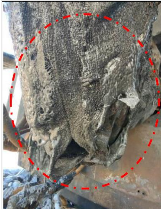
Figura 22. Restos cristalizados de la manta térmica cobertora del escape de gases. Fuente: Informe Técnico BV, 2021
