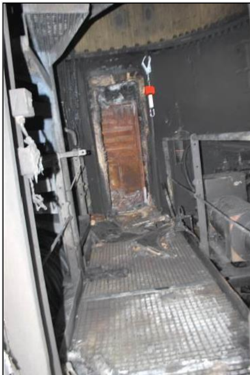
Figura 32. Efectos del fuego en la zona central y en la sala del cabrestante
