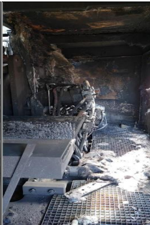
Figura 33. Efectos del fuego en la zona central y en la sala del cabrestante
