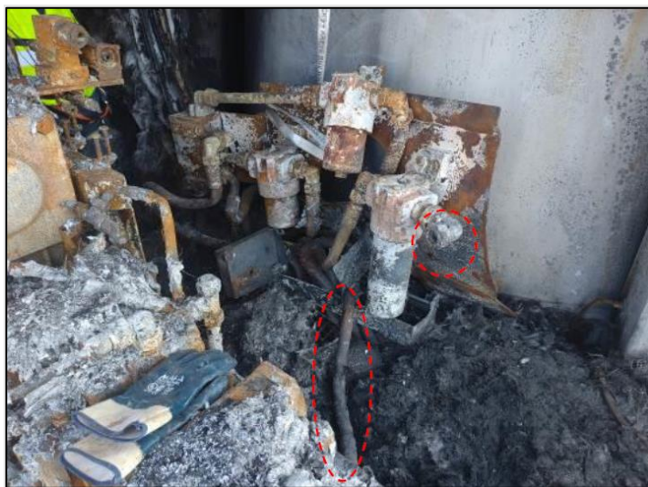
Figura 37. Placa soporte y filtros de aceite hidráulico. Fuente: Informe Técnico BV (04/2021)
