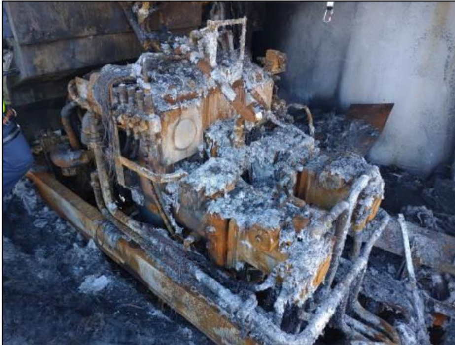
Figura 29. Efectos térmicos sobre los diferentes materiales en la sala de máquinas
