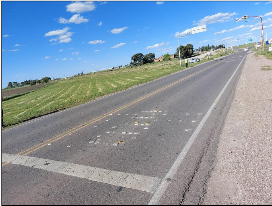
Figura 16. Vista de tachas retrorreflectantes sobre calzada, en sentido oeste – este
