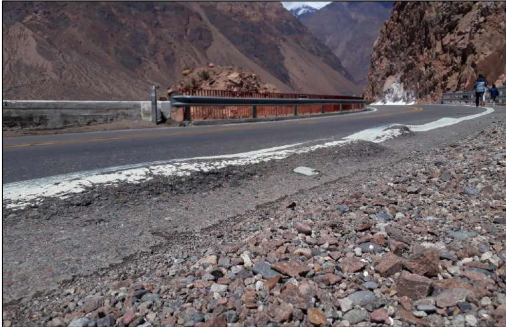
Figura 8. Ondulaciones en el borde externo oeste de la curva, próximo al inicio del puente (N-S). Fuente: JST, 2021.
