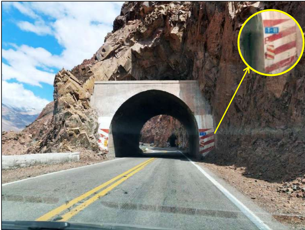
Figura 4. Panorámica del conductor previo al lugar del accidente. Ingreso al Túnel cordillerano 11. Fuente: JST, 2021.
