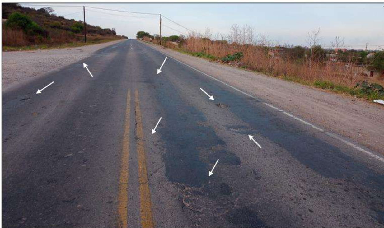
Figura 5. Fotografía con vista sur-norte donde se observa el estado de la calzada y sus fallas. Fuente: JST, 2021.
