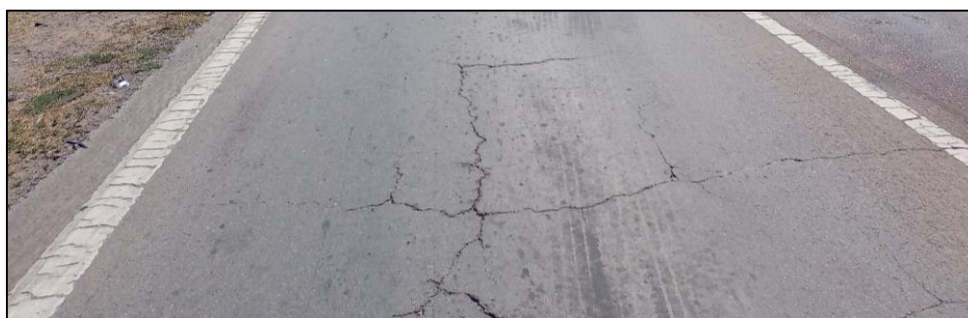
Figura 5. Fotografía de un grupo de grietas y fisuras observadas sobre la calzada de la ruta en el tramo relevado. Fuente: JST, 2021.
