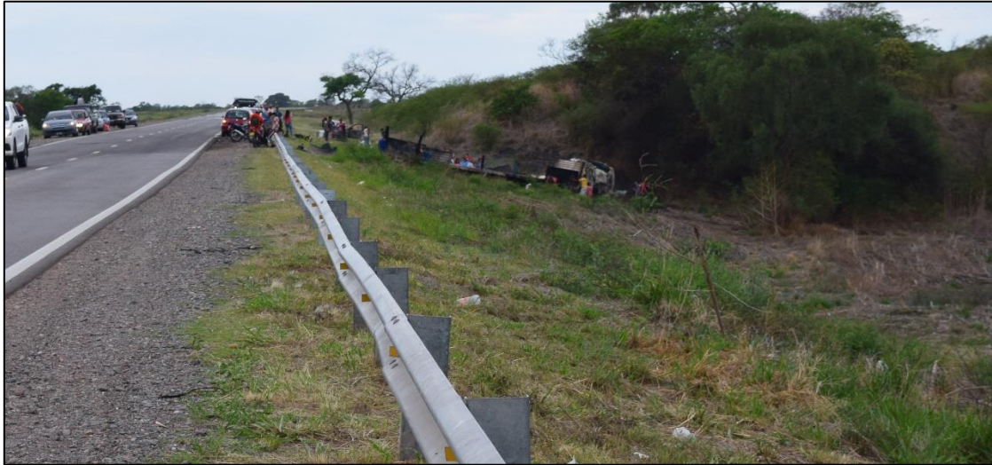
Figura 4. Características de los costados sur de la calzada. Fuente: JST, 2021.
