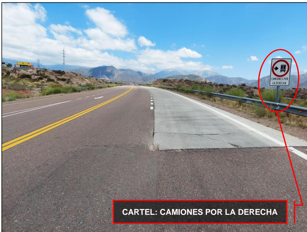
Figura 15. Vista panorámica desde el Vehículo 2. A la derecha de la imagen, señal vertical reglamentaria. Se observa el inicio de una nueva carpeta asfáltica sobre el carril derecho. Fuente: JST, 2021.
