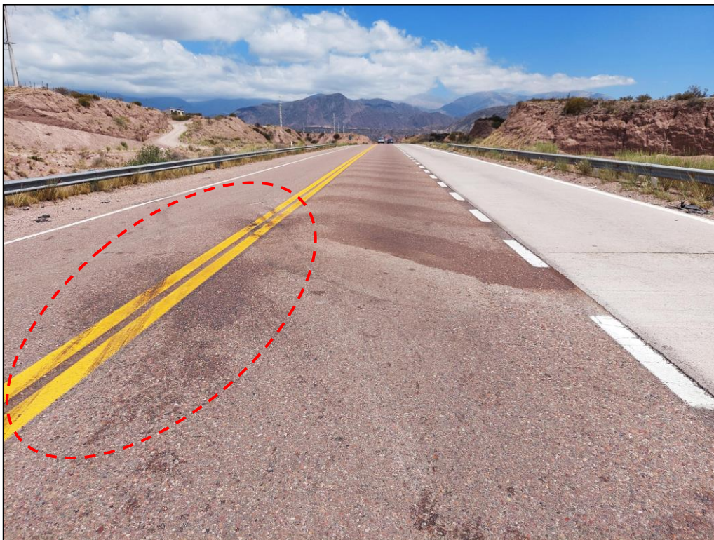
Figura 22. Zona geográfica de impacto: obsérvese vestigios del suceso, en las adyacencias y sobre la doble línea amarilla de la calzada. Fuente: JST, 2021.
