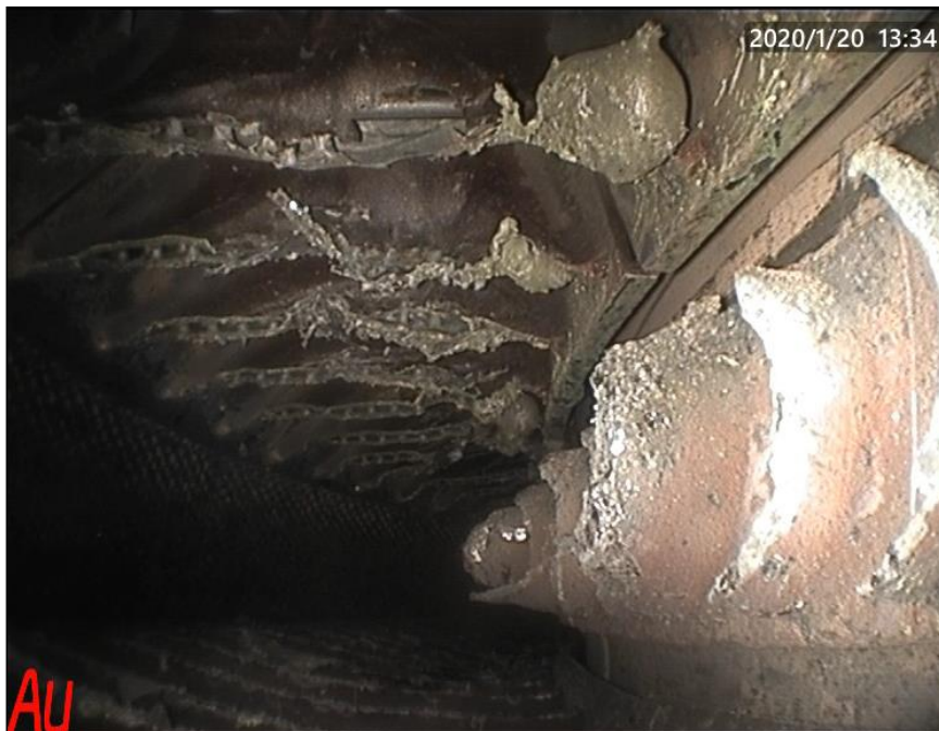
Figura 2. Daños en álabes de LPT. Fuente: Austral
