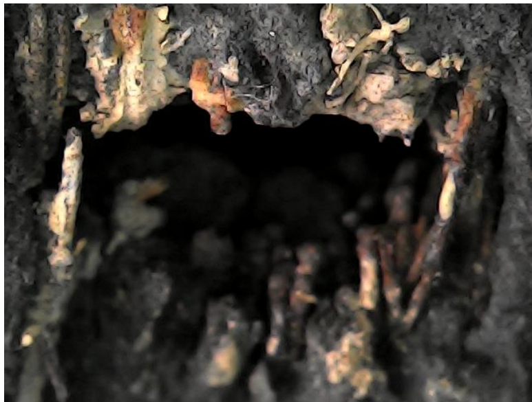
Figura 28. Extremos de alambres en el hueco de la pinchadura
