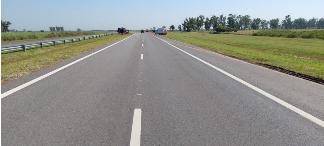
Figura 13. Geometría, configuración y estado de la vía
