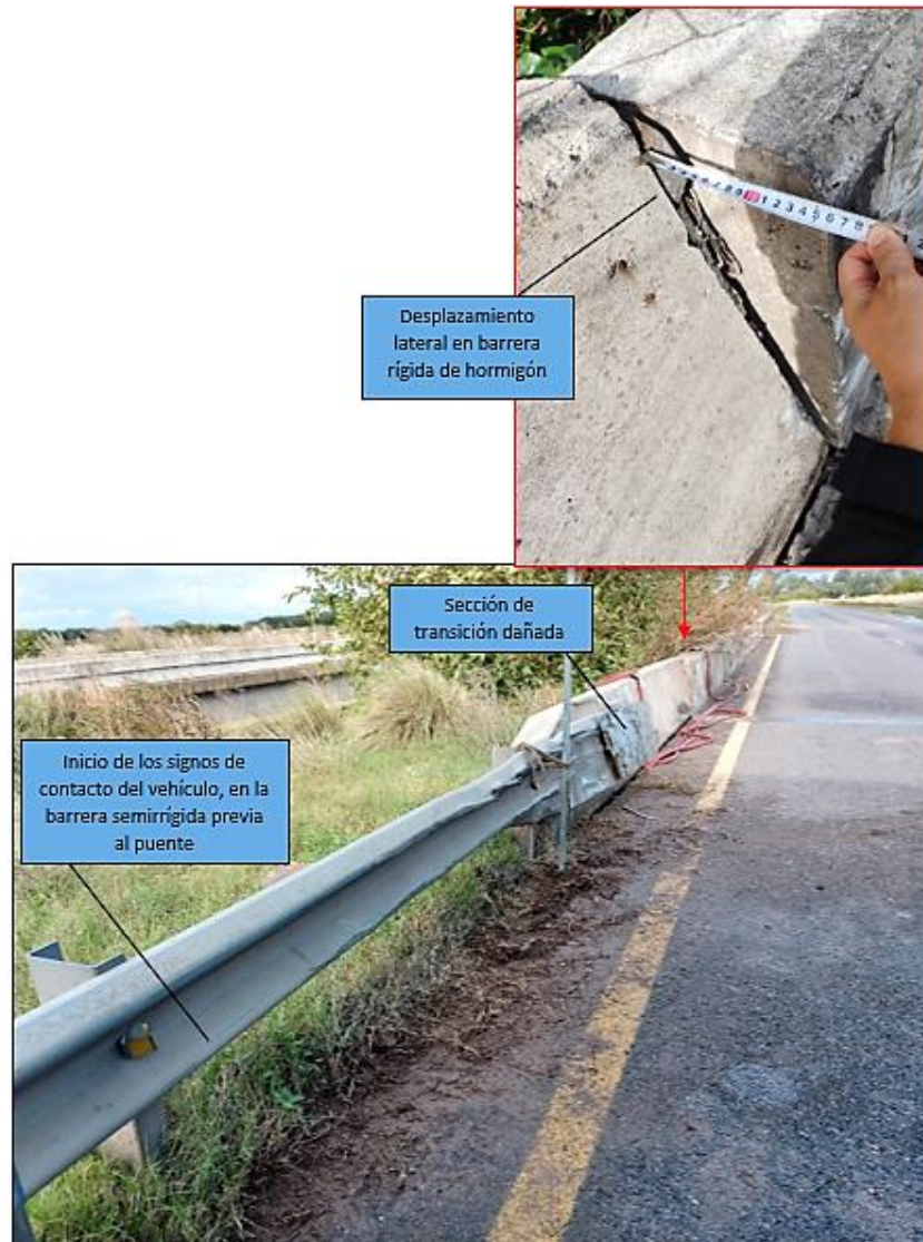
Figura 4. Barreras de contención en el lugar del suceso. Fuente: JST, 2022.
