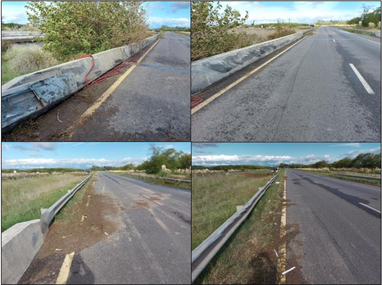
Figura 5. Daños en las barreras de contención. Fuente: JST, 2022.
