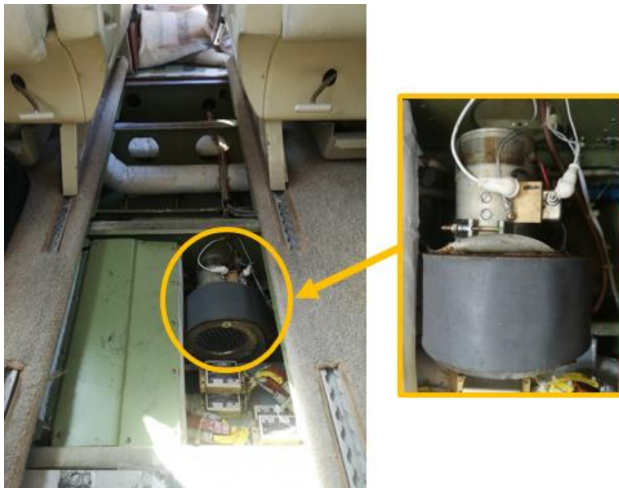
Figura 2. Daños en el aft evaporator blower
