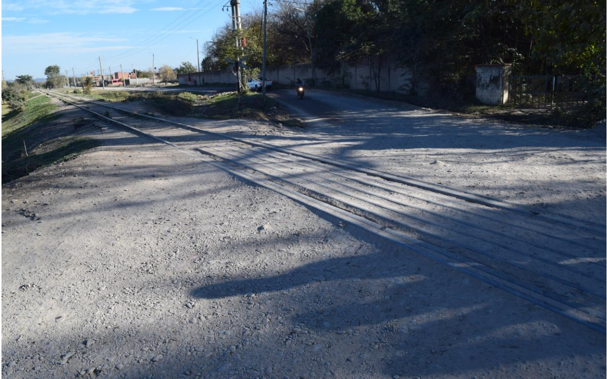
Figura 17. Vista lateral del paso a nivel Solís Pizarro y la calle de tierra. Fuente: JST, 2021
