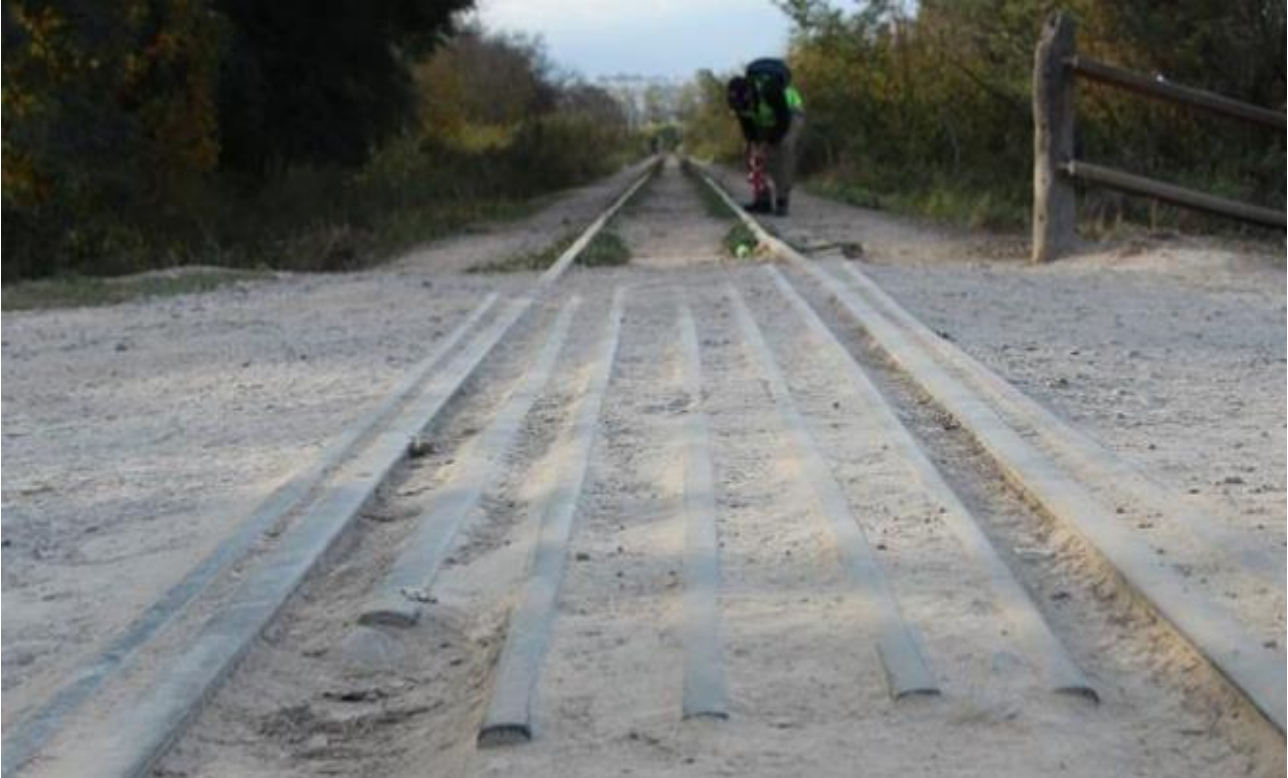
Figura 3. Cama de rieles del paso a nivel Solís de Pizarro. Fuente: JST, 2021
