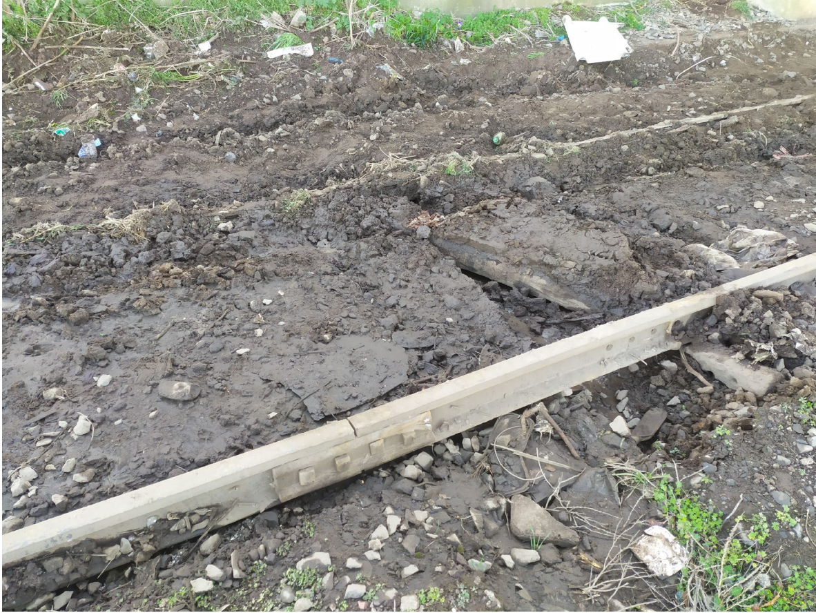
Figura 8- Estado del balasto Fuente: Investigador en el lugar del Suceso.
