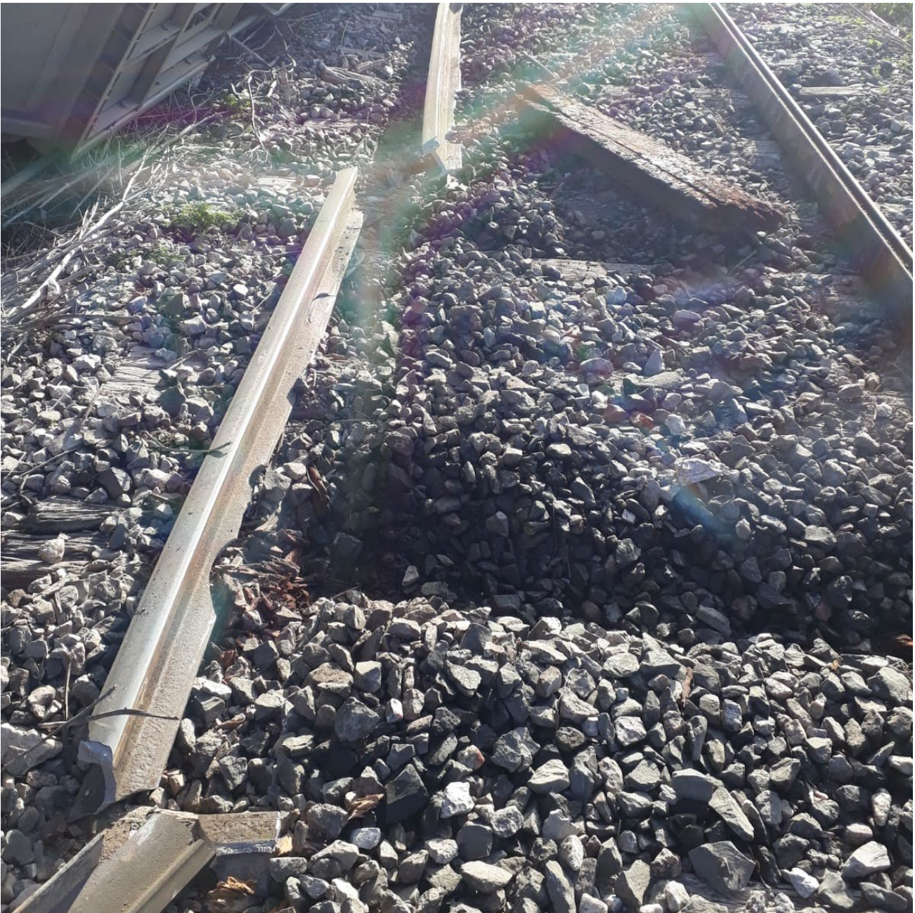
Figura 5 -Daños en la superestructura de vía - Fuente: Archivo JST
