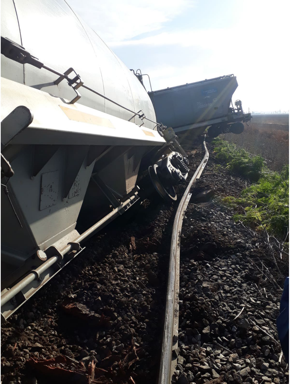
Figura 6- Daños en la superestructura de vía- Fuente: Archivo JST
