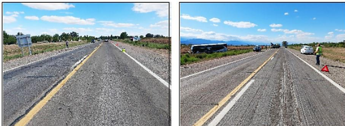
Figura 2. Vistas generales del lugar del suceso. Fuente: JST, 2022
