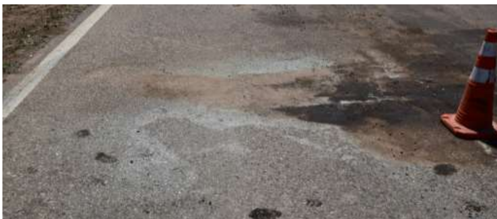
Figura 15. Mancha estática de fluidos oleosos y polvo de matafuegos que evidencian la ubicación final del Vehículo 2. Fuente: JST, 2022
