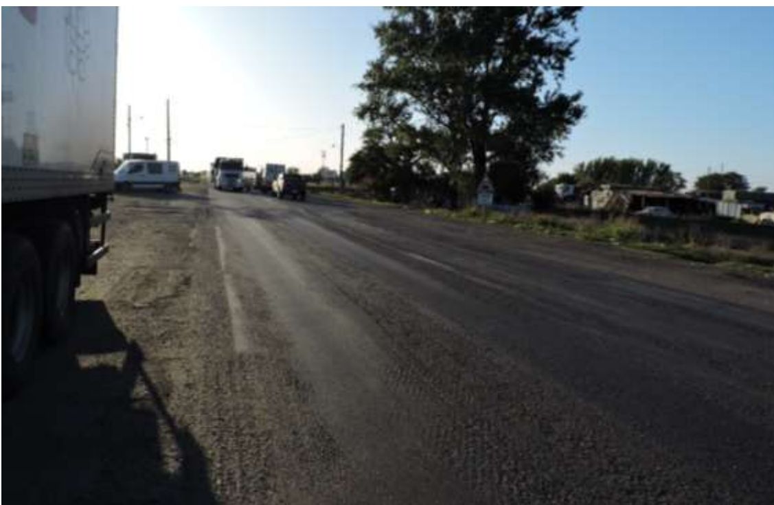
Figura 4. Ruta Nacional 34, imagen tomada hacia Ibarlucea, previo al cruce con la RN A012. Vehículos detenidos sobre la calzada. Fallas sobre el pavimento. Fuente: JST, 2022
