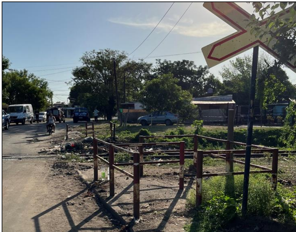
Figura 7. Laberintos peatonales corroídos, presencia de cúmulos de residuos en la zona de vía y cruz de San Andrés obstruida con vegetación. Fuente: JST, 2023
