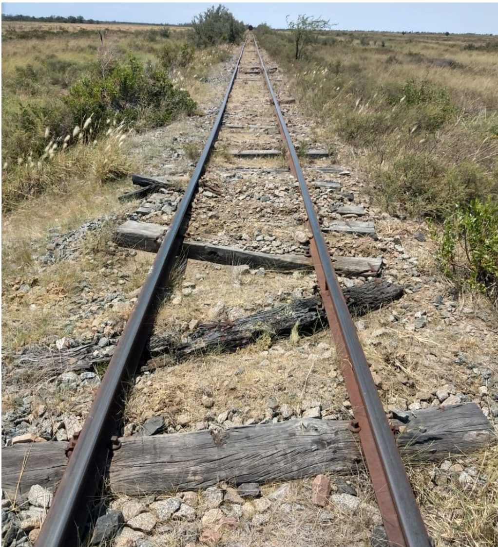
Figura 7. Estado de la vía en el sector previo al descarrilamiento. Fuente: Archivo JST
