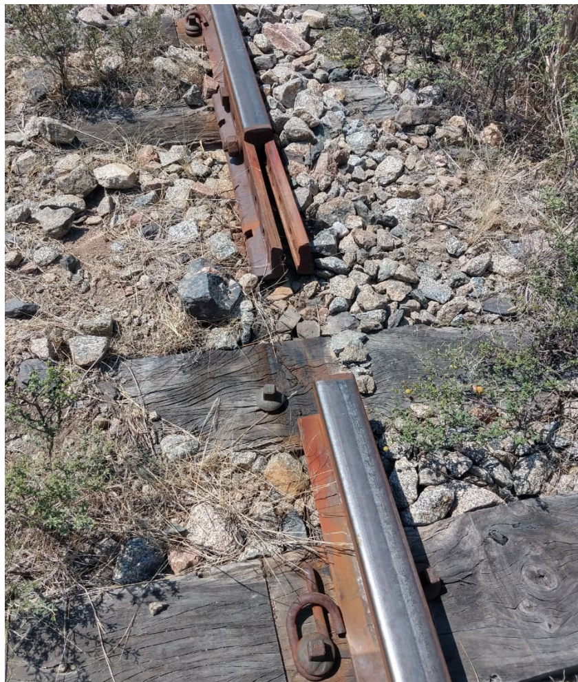
Figura 9. Eclisa con faltante de bulones. Fuente: Archivo JST
