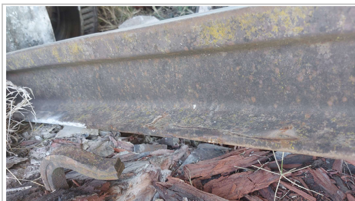
Fig. 4. Marcas generadas por las fijaciones sobre el patín del riel. Fuente: JST
