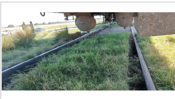
Fig. 3. Punto de inicio del descarrilamiento, en dirección contraria a la marcha del tren. Fuente: JST
