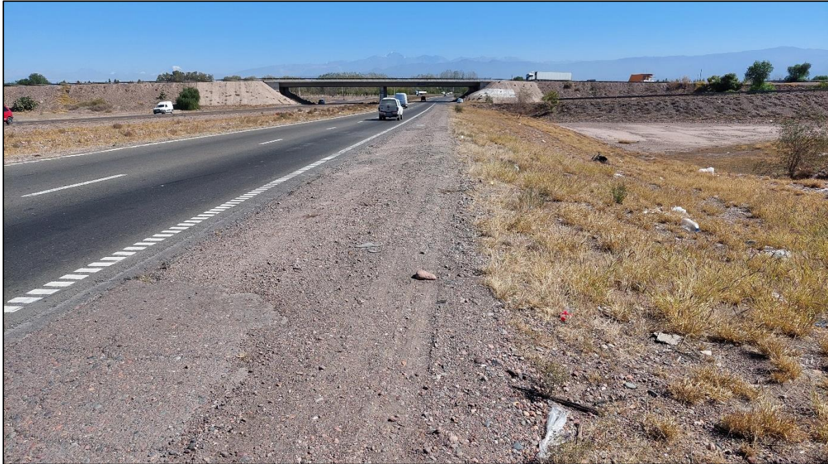
Figura 5. Vista general del lugar del suceso, antes del puente de la Ruta Provincial 50. Se observa calzada norte, mano hacia Mendoza (este a oeste), banquina, talud y terraplén norte. Fuente: JST, 2023
