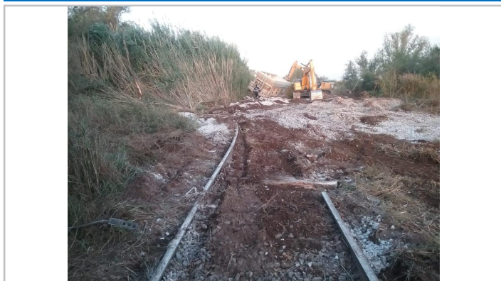
Figura 1. Imagen de los daños en la superestructura. Fuente: JST, 2023
