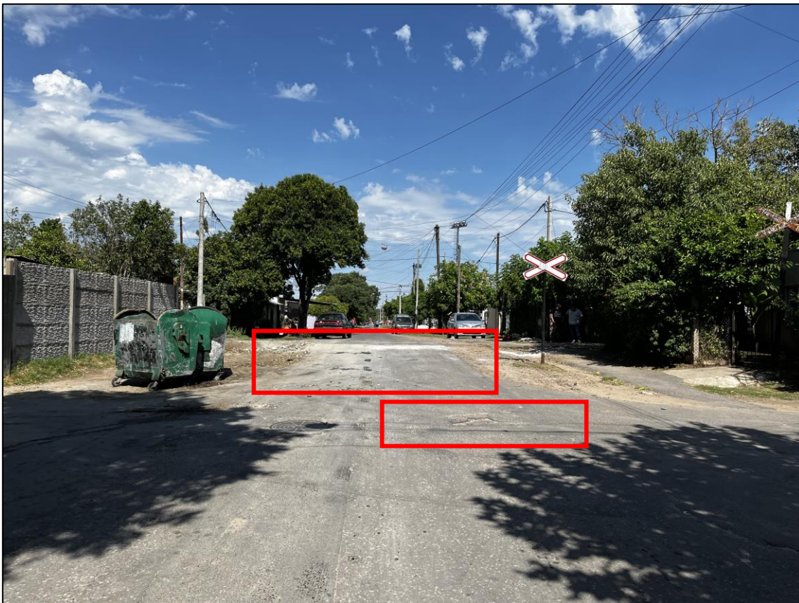
Figura 5. Estado de la calzada: aristas indefinidas y presencia de baches. Fuente: JST, enero 2023
