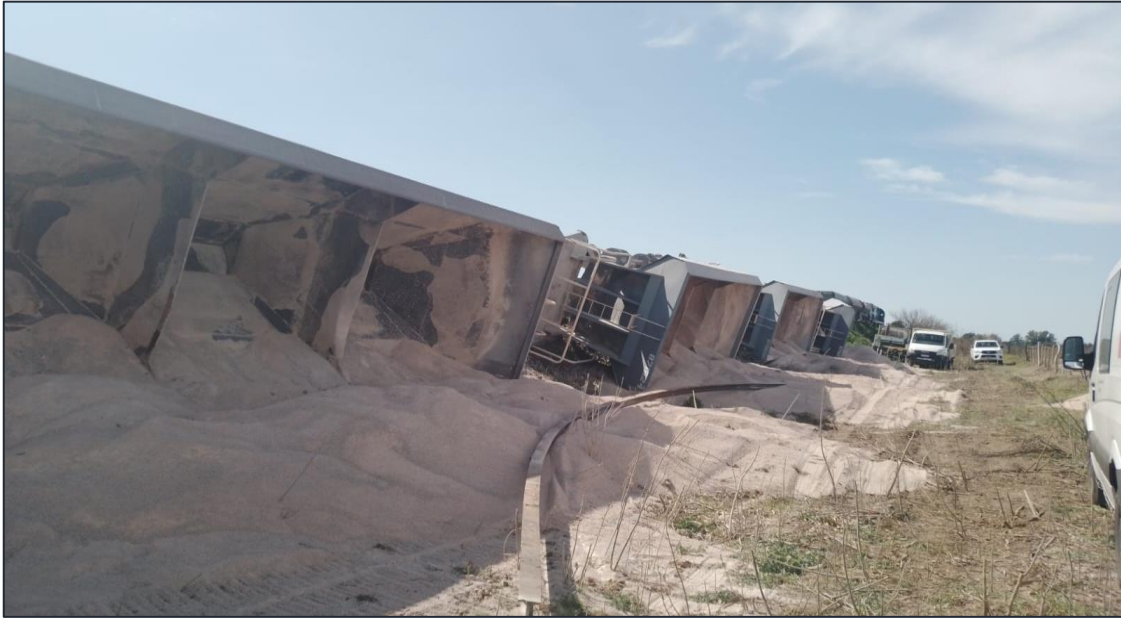
Figura 3. En la imagen se observa a una de las barras de riel deformada y desprendida de la vía.
