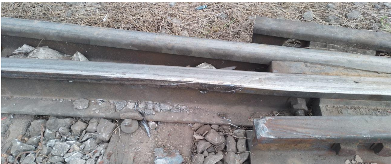
Figura 3. Daños en el ADV. Fuente: JST, 2022
