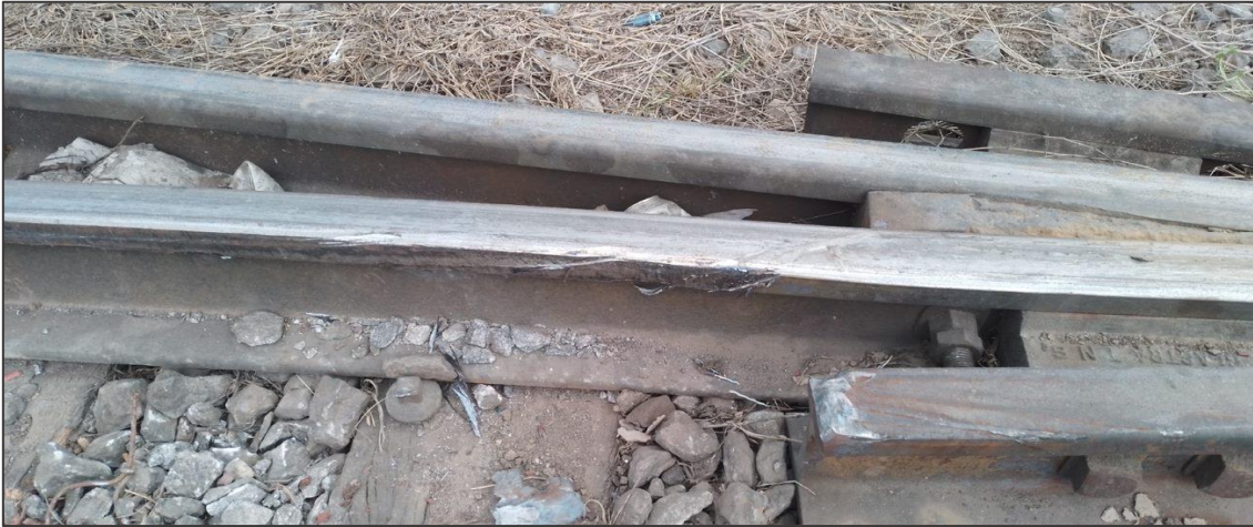
Figura 3. Daños en el ADV. Fuente: JST, 2022
