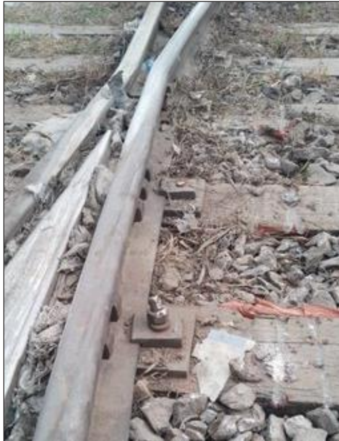
Figura 4. Daños en la superestructura de vía. Fuente: JST, 2022
