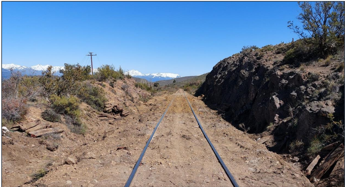
Figura 5. Imagen de la zona del suceso registrada durante el relevamiento del 12 de octubre de 2023. Fuente: JST, 2023
