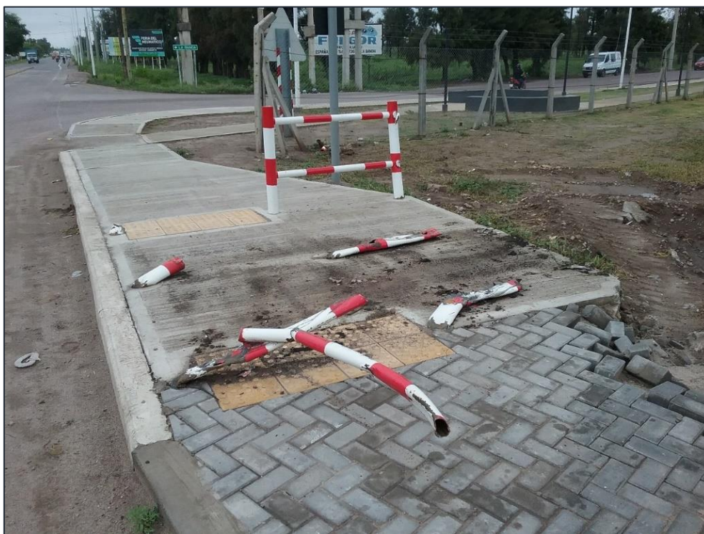
Figura 2. Daños en las defensas peatonales del PAN. Fuente: JST, 2023
