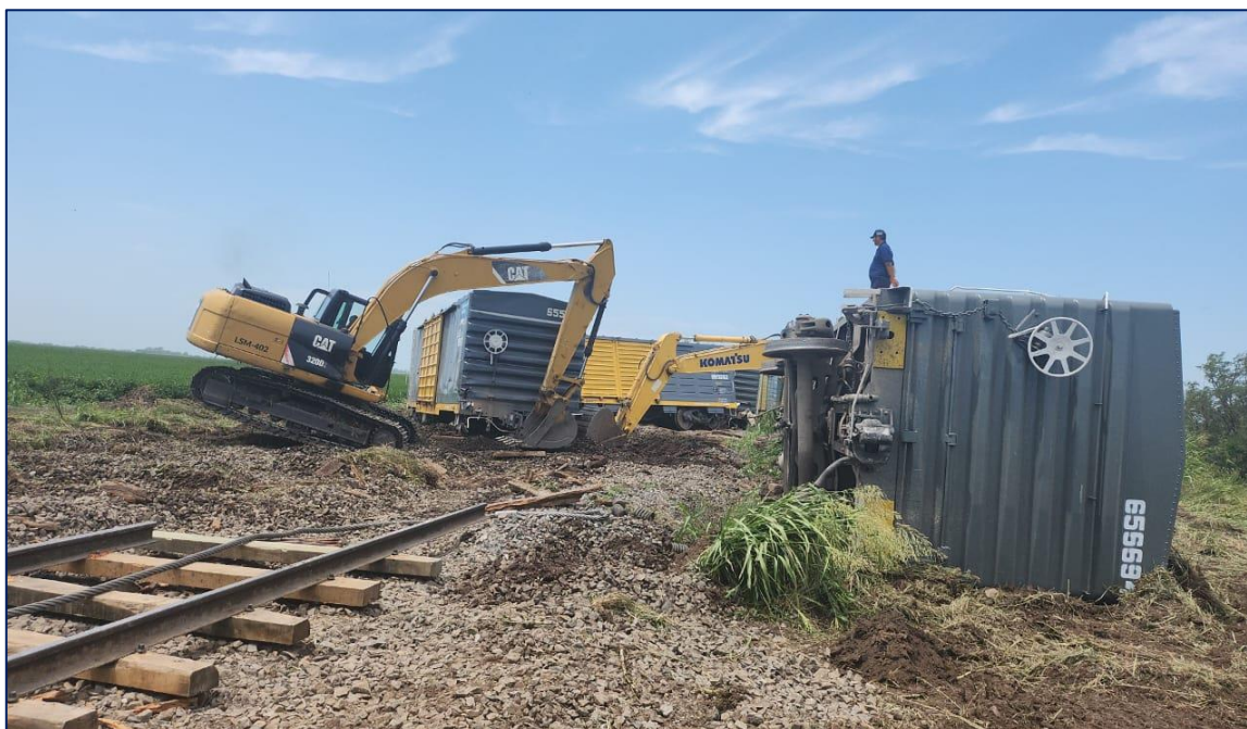
Figura 1. Vagones descarrilados pertenecientes al tren G10. Fuente: JST, 2024
