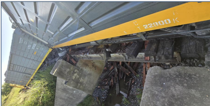
Figura 2. Vagón descarrilado sobre una alcantarilla. Fuente: JST, 2024
